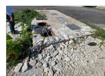
7 Demolizione della pavimentazione in c.a. fino a quota -0,15m per successivo ripristino pavimentazione bituminosa come da prescrizione MSP.
